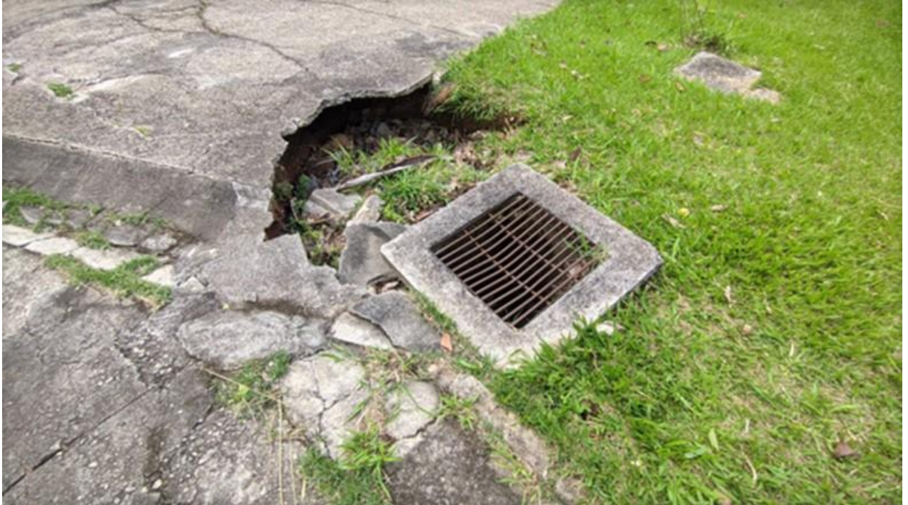
Foto 3: Piso “oco” com afundamento
