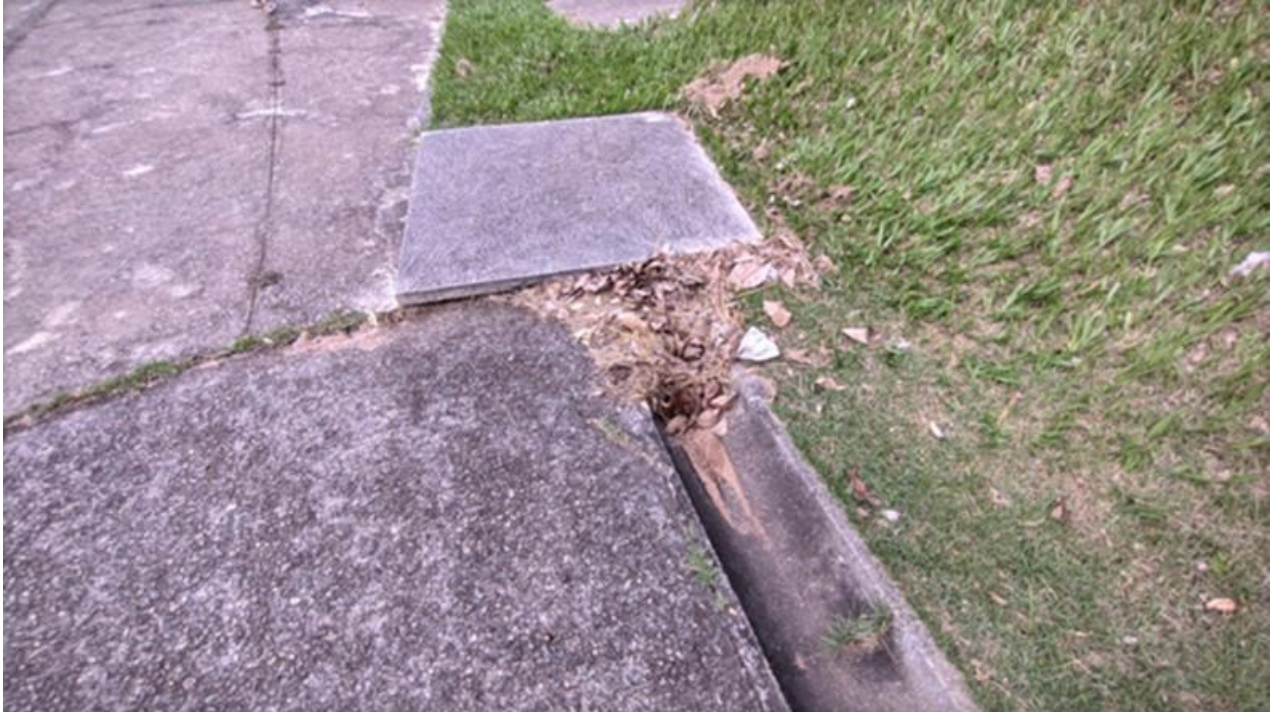
Foto 8: Canaletas de escoamento de água obstruídas
