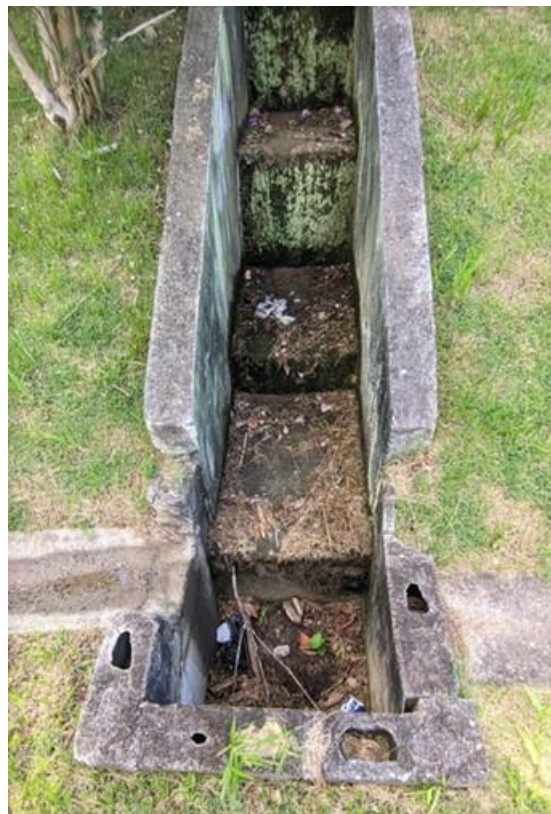
Foto 11: Escada hidráulica obstruída por vegetação
