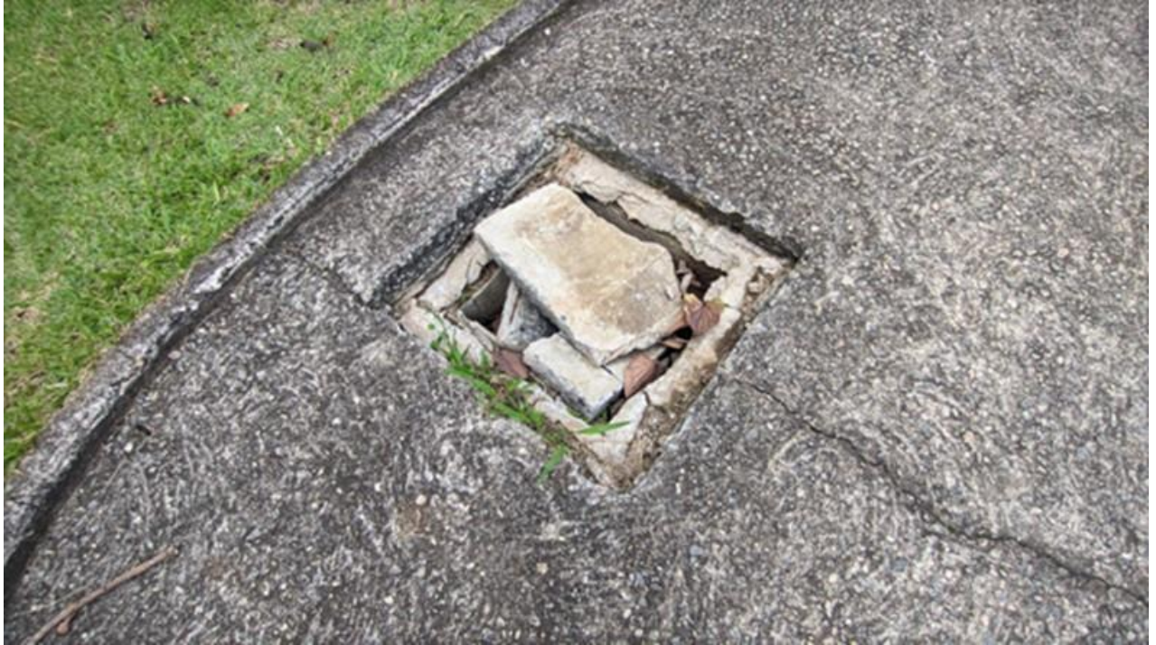
Foto 5: Caixas de alvenaria com tampas quebradas
