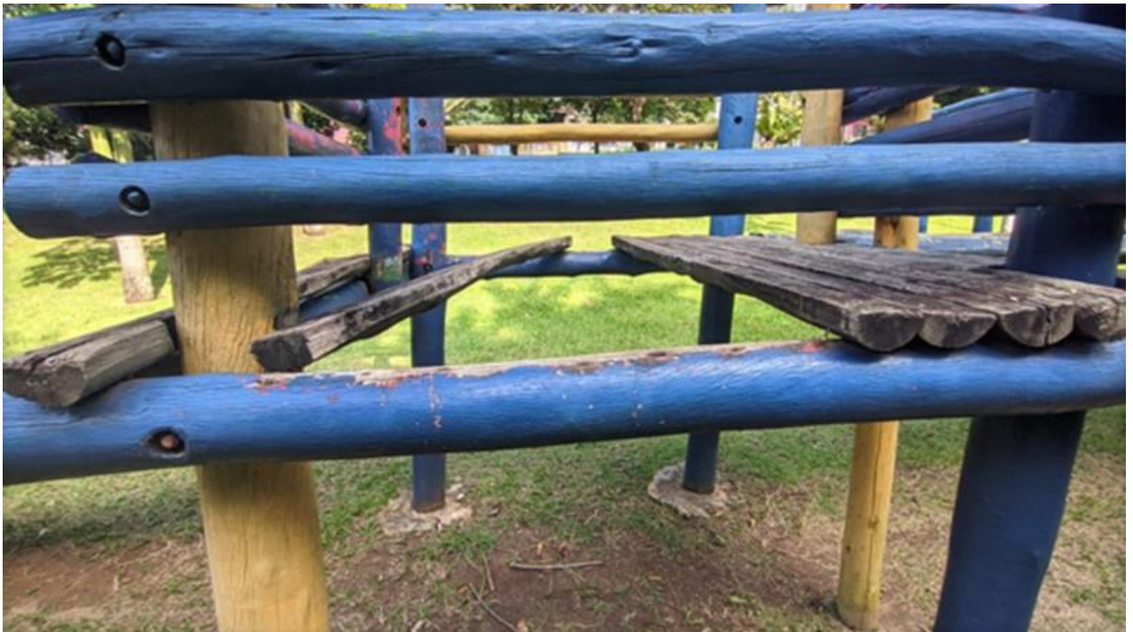
Foto 9: Parque de Madeira – Faltam madeiras no piso
