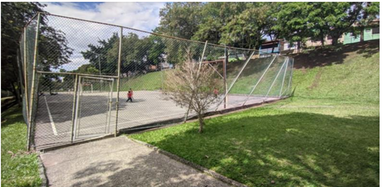
Foto 2: Estrutura e alambrado da quadra comprometidos
