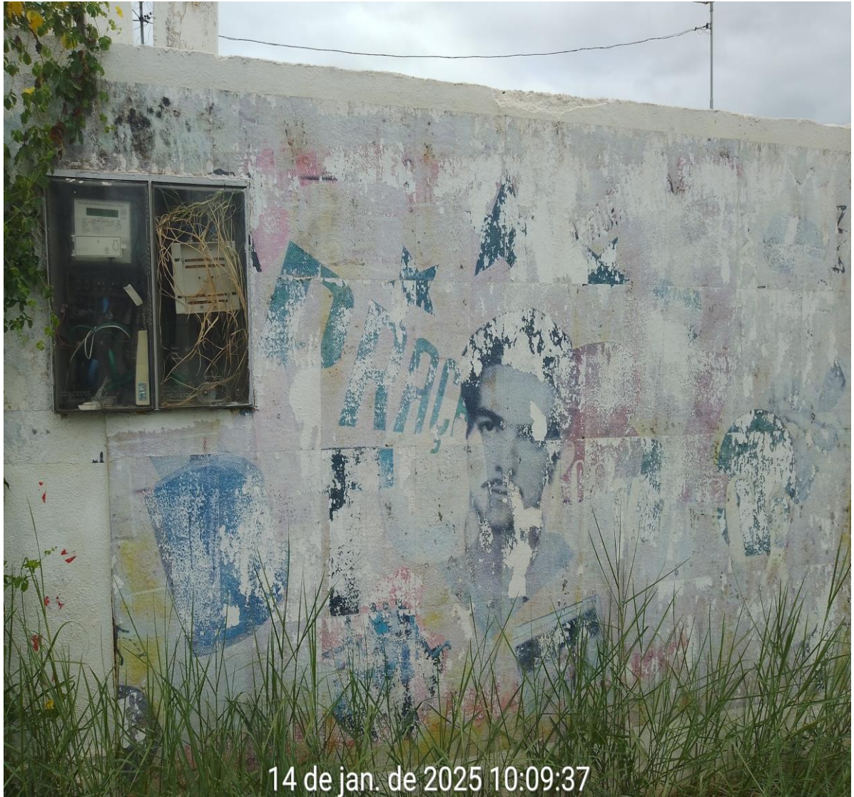
Foto 2 - Quadro de energia instalado no Mural da Praça de Esporte Benedito Rosa da Silva - Dito Bozo - Jardim Pedramar (com vegetação no interior do quadro)
