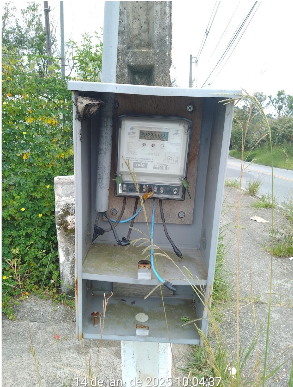
Foto 1 - Quadro de energia sem fechamento, instalado na Praça de Esporte Benedito Rosa da Silva - Dito Bozo - Jardim Pedramar
