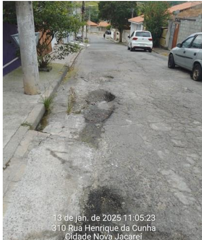
Foto 1: Rua Henrique da Cunha, altura do nº 325, no Bairro Cidade Nova Jacareí
