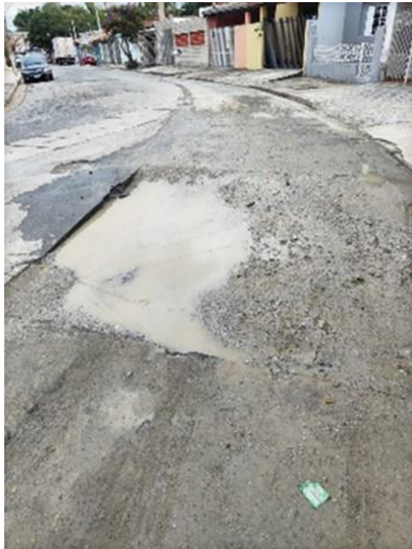
Foto 1: Avenida São Matheus, defronte ao nº 218, no Jardim São José
