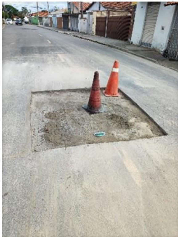
Foto 2: Avenida São Marcos, defronte ao nº 114, no Jardim São José
